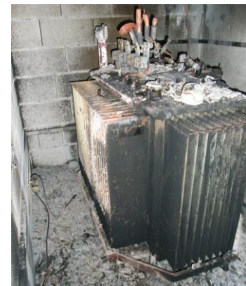
Brand eines Transformators nach einem Störlichtbogen
